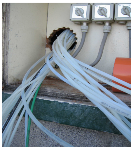
Figuur 4: Leidingen die het gas het gebouw inbrengen.
