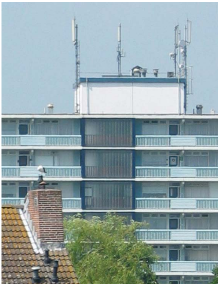
Figuur 8 Voorbeeld van een dakopstelling van GSM-antennes
