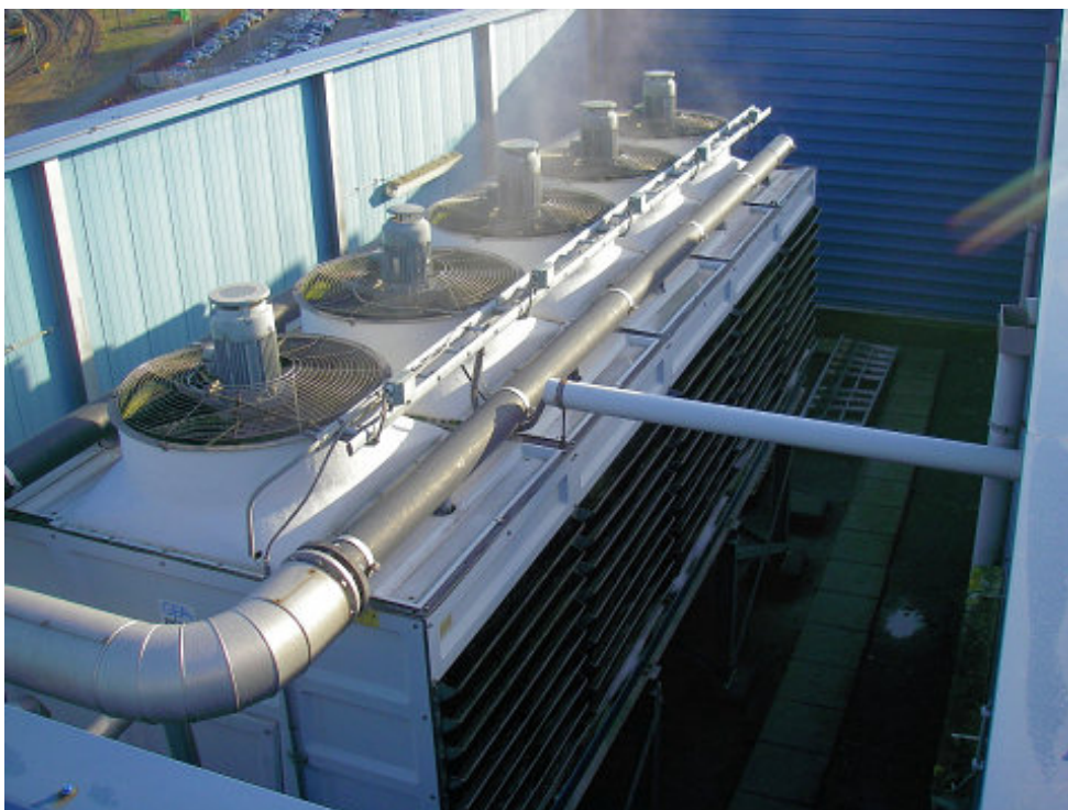
Figuur 1. Natte koeltorens in Apeldoorn – op een dak weggewerkt achter een opbouw (bron: Jan Rullens, Kenniscentrum InfoMil)
