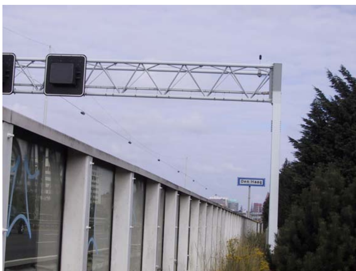
Figuur 2.1 Geluidmonitor geïnstalleerd op het portaal boven de A12 bij Voorburg hectometer 4.65
