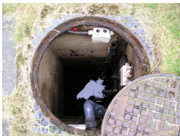
Ondergronds opslagreservoir voor opgevangen regenwater
