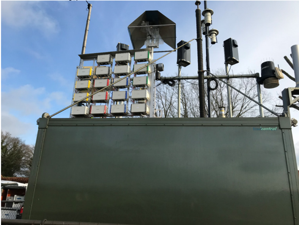
Figuur 3 De meetbehuizingen met NH 3 -sensoren geïnstalleerd op een rek dat op het dak van een LML-meetcontainer is geplaatst
