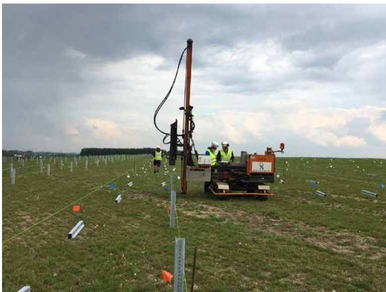
Figuur 3. De aanleg van een zonnepark gaat soms gepaard met intensief vrachtverkeer, bouwrijp maken van de bodem en andere graafwerkzaamheden (foto van het AVRI zonnepark bij Beneden-Leeuwen).
