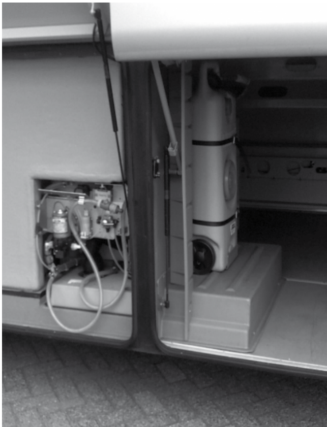
Figuur 2 De waterinstallatie van de bus met een schoonwatertank en een afvalwatertank
