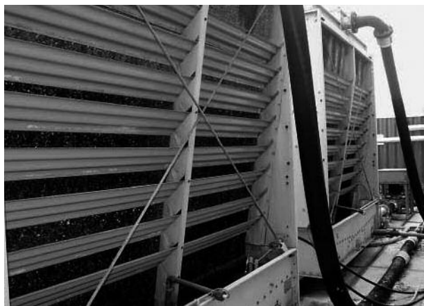
Figuur 2. Inlaatkanten van koeltorens waardoor buitenlucht wordt aangezogen. In een koeltoren wordt warm koelwater gekoeld door het te sproeien door de buitenlucht binnenin de toren. De warmte wordt door een uitlaatopening bovenaan de toren afgevoerd met de luchtstroom. Daarbij vernevelt een deel van het water, waardoor een koeltoren vochtige damp afgeeft. Het grootste deel van het water valt gekoeld in een bak onderin de toren, waaruit het wegstroomt om opnieuw als koelwater te worden gebruikt.
