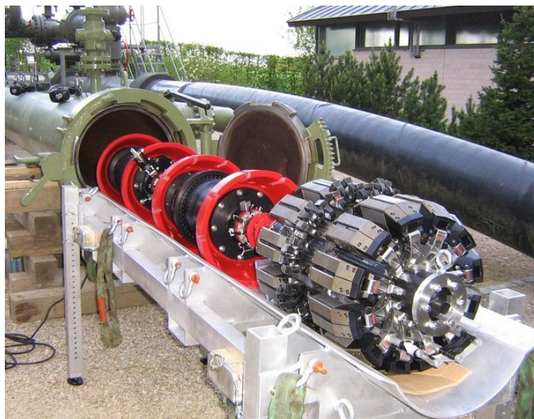
Figuur 2: Intelligent pigging wordt uitgevoerd in gasleidingen om externe corrosie en deuken te detecteren (Foto: Gaznat)
